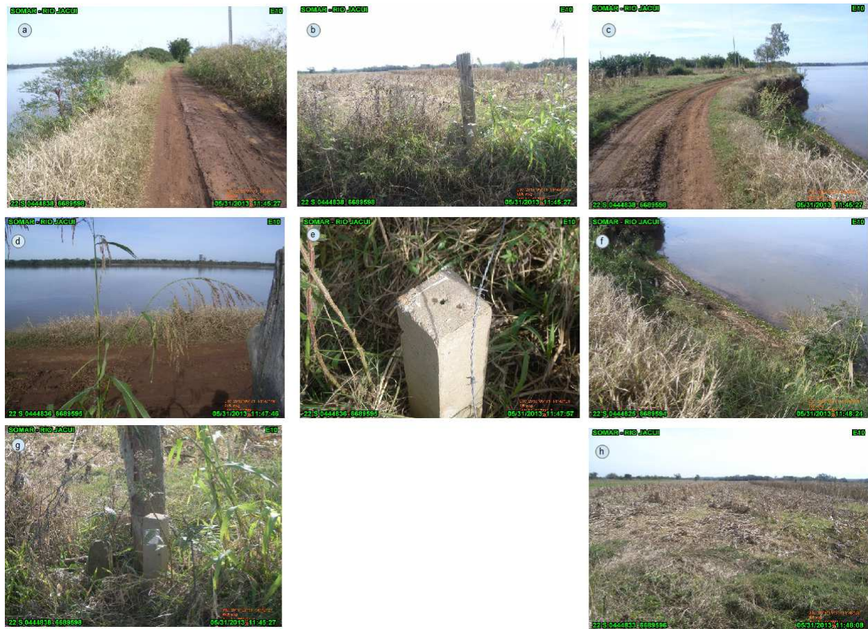
Figura 31. Marco E10 localizado na margem esquerda do rio Jacuí, Triunfo; (a) vista da estrada municipal e da margem para montante; (b) marco e interior; (c) detalhe do talude para jusante, onde ocorre intenso processo erosivo; (d) vista da estrada e do rio desde o marco; (e) marco; (f) base do talude com ocorrência de seixos rolados; (g) marco e moirão da cerca; (h) resteva de milho.
