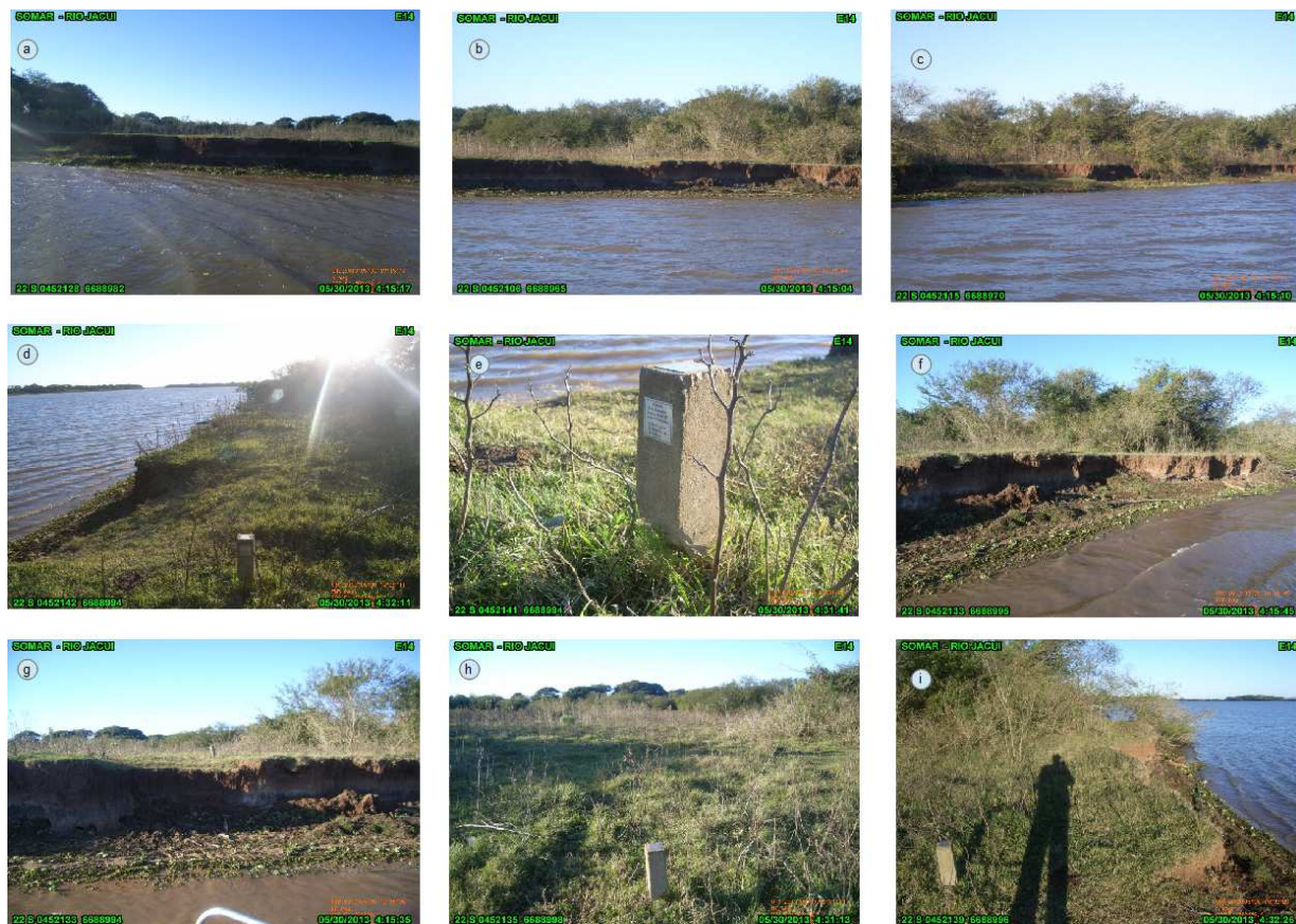
Figura 43. Marco E14 localizado na Ilha do Araújo, margem esquerda do rio; (a) (b) (c) vista da margem/talude; (d) margem para jusante; (e) marco com base avariada; (f) vista do talude para jusante; (g) detalhe do talude; (h) marco e vista para o interior; (i) margem para jusante.
