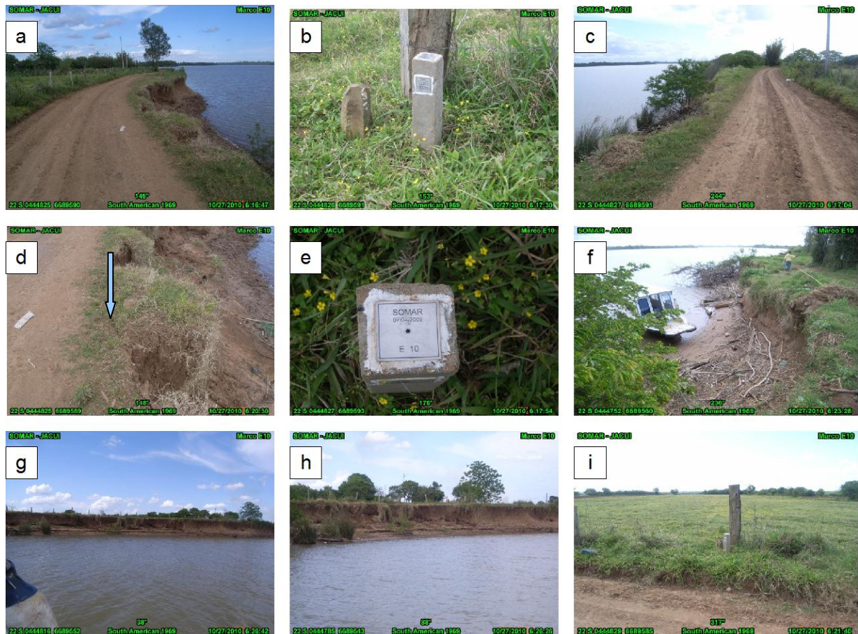
Figura 38. Marco E 10 localizado na margem esquerda do rio Jacuí, Triunfo; (a) vista da margem e talude para jusante; (b) vista do marco; (c) vista para montante e estrada; (d) vista do talude, estrada e detalhe da fissura no talude indicada pela seta; (e) marco; (f) detalhe do talude para montante ocorrência de seixos; (g) vista da margem; (h) detalhe da margem e do talude; (i) marco e interior terreno em processo de preparo da terra para plantio de milho.
