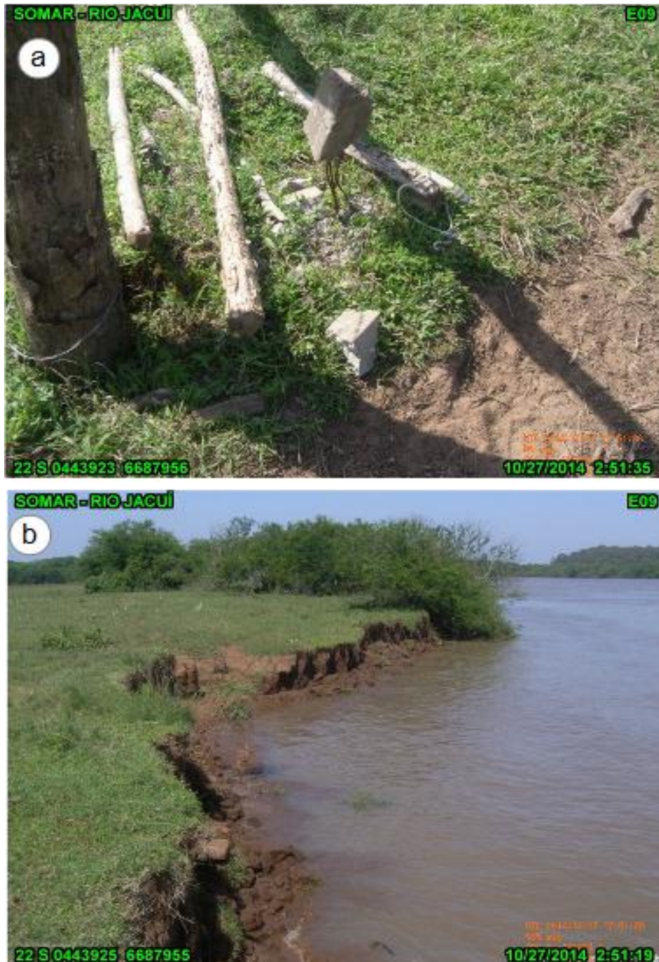
Figura 30 - Marco E09, localizado na Ilha dos Dornelles. (a) marco avariado; (b) talude para jusante. Imagens obtidas em outubro de 2014.
