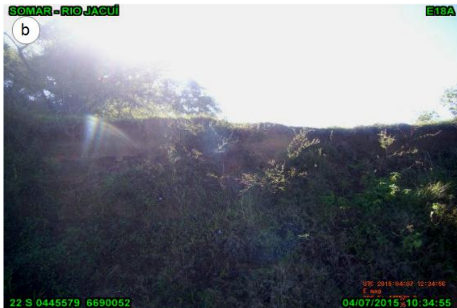
Figura 53 - Marco E18A localizado na Ilha do Fanfa. (a) marco danificado; (b) talude.
