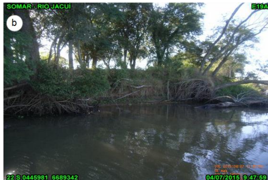
Figura 57 - Marco E19A localizado na ilha do Fanfa. (a) marco; (b) aspecto do talude/margem com queda de árvores.
