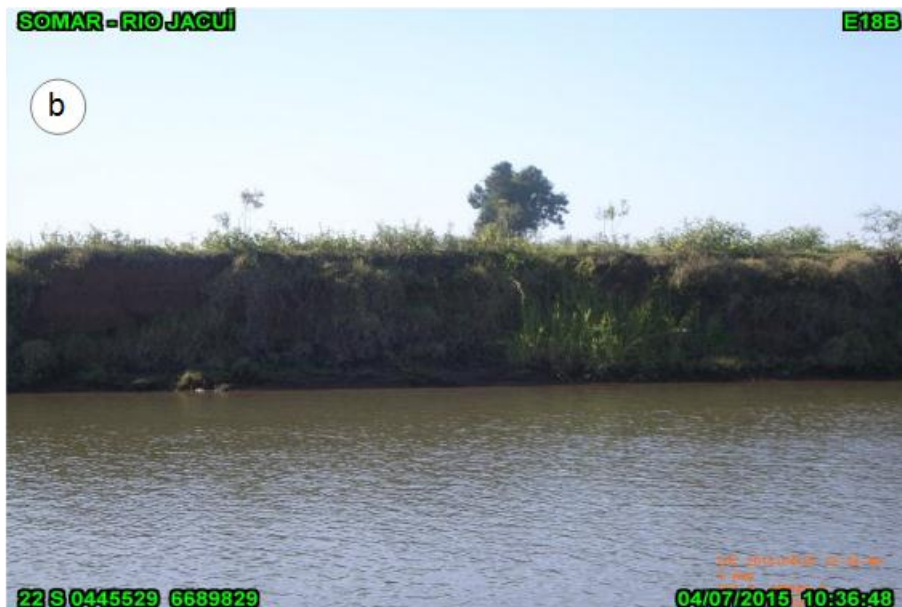
Figura 55 - Marco E18B localizado na ilha do Fanfa. (a) marco; (b) talude e margem. Observa-se a fixação de vegetação de pequeno porte na base do talude.
