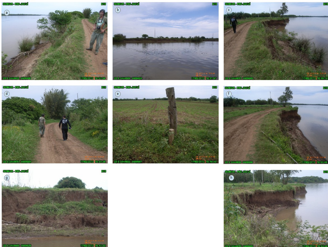
Figura 33. Imagens do Marco E10 e imediações localizado na margem esquerda do rio Jacuí, Triunfo; (a) vista da estrada municipal e da margem para montante; (b) vista da margem; (c) detalhe do talude para jusante, com solapamento do talude e onde ocorre intenso processo erosivo; (d) vista da estrada; (e) marco e interior; (f) base do talude com ocorrência de seixos rolados de ocorrência antrópica; (g) talude com material erodido e depositado na base e/ou praia; (h) detalhe do talude/margem para jusante.
