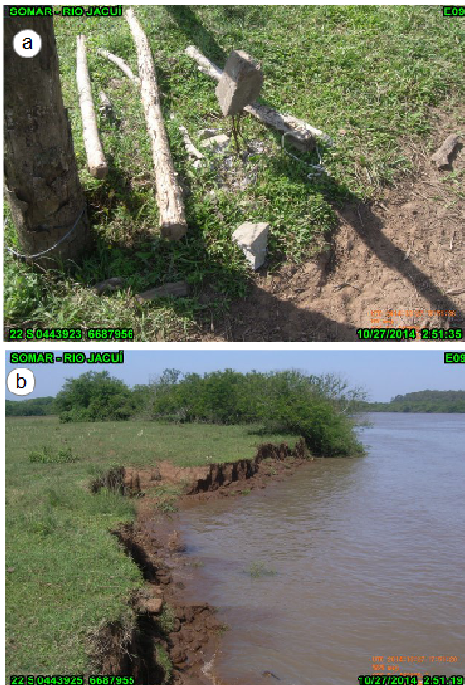
Figura 29ab. Marco E09, localizado na Ilha dos Dornelles. (a) marco avariado; (b) talude para jusante.
