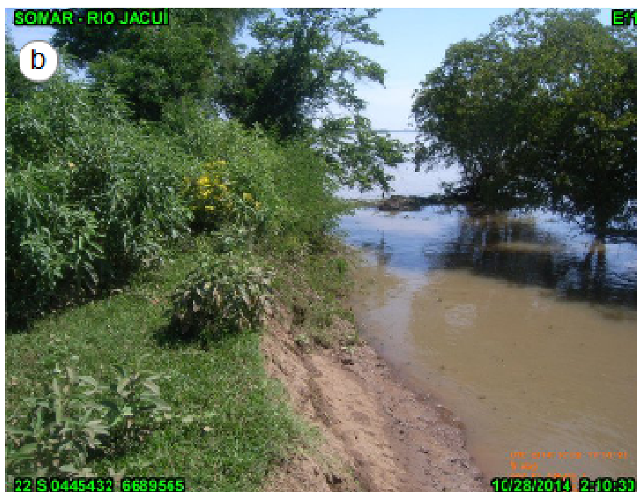
Figura 34ab. Marco E11, localizado no pontal oeste da Ilha do Fanfa. (a) marco; (b) talude.
