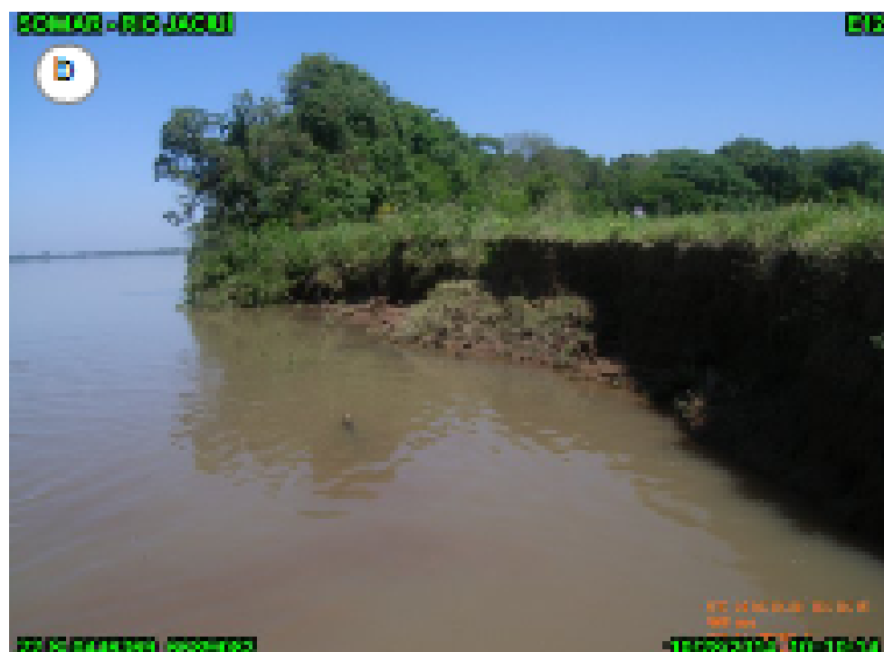
Figura 38ab. Marco E12 A, localizado na ilha do Fanfa, (a) marco; (b) Talude para montante.
