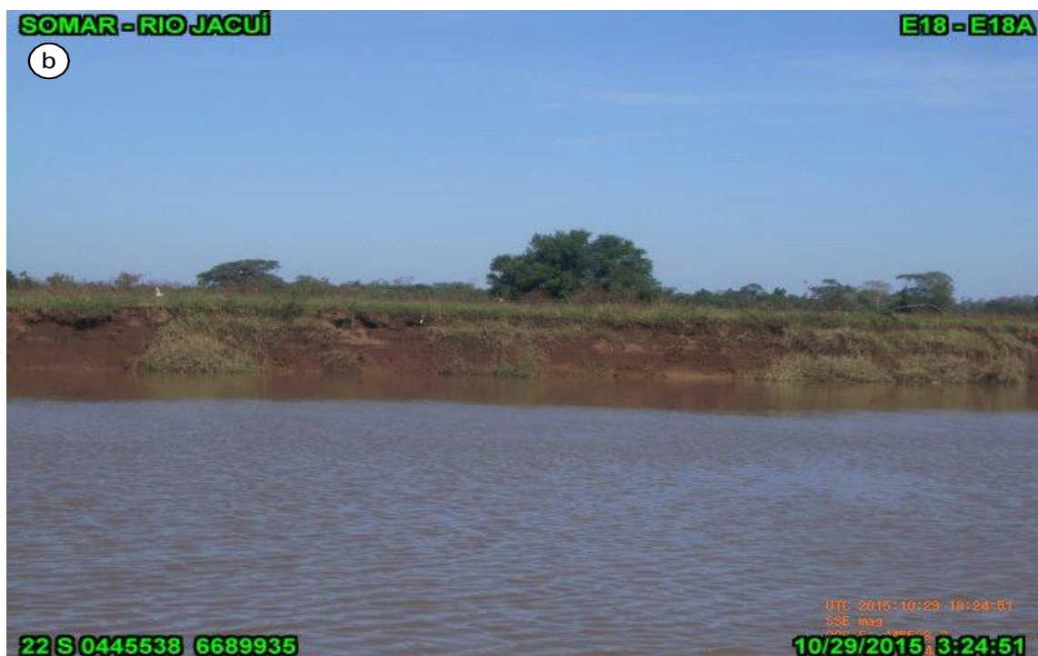
Figura 52: (ab) Marco E18B localizado na ilha do Fanfa. (a) marco; (b) talude e margem. Observa-se a formação de degraus pelo solapamento do talude superior.
