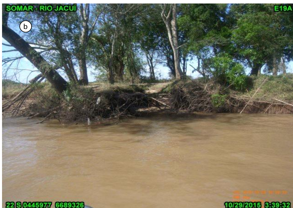
Figura 54: (ab) Marco E19A localizado na ilha do Fanfa. (a) marco; (b) aspecto do talude/margem com queda de árvores.
