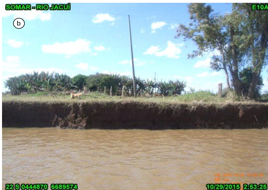
Figura 28: (ab) Marco E10A, localizado no município de Triunfo. (a) poste da CEEE utilizado como marco; (b) marco, margem e talude vertical.
