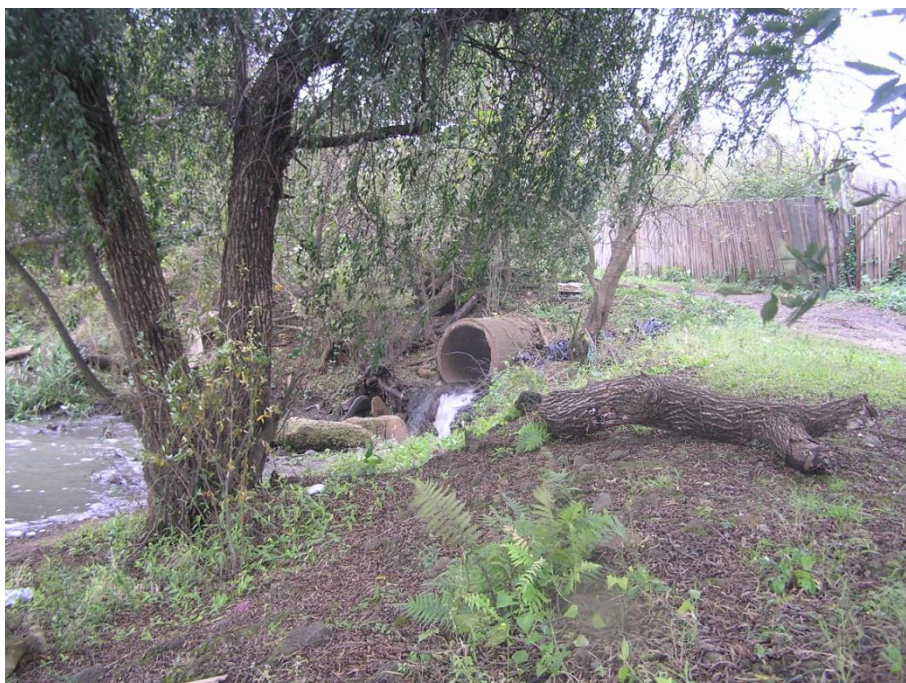
Figura 12. Esgoto desembocando na margem do rio Jacuí
