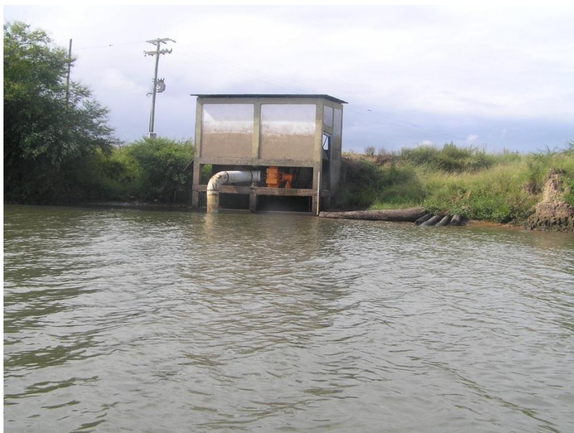
Figura 8. Bomba de irrigação
