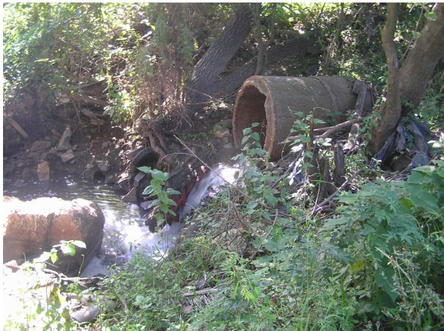
Figura 17. Descarte de esgoto doméstico para dentro do rio Jacuí.
