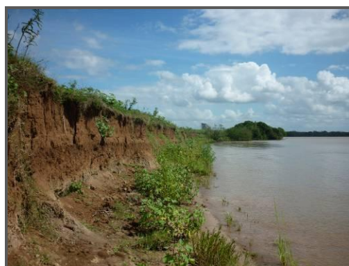
Foto 15: Segmento onde houve total supressão da mata ciliar, observando-se o barranco formado pela erosão da margem desprotegida.
