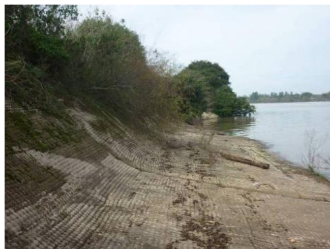
Foto 18: Ilha das Cabras: Proteção das margens para resguardar as torres da linha de alta tensão, executada em concreto.
