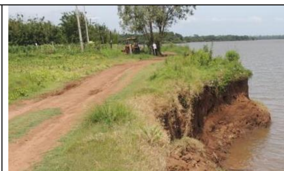
Foto 43: Detalhe da erosão da margem
