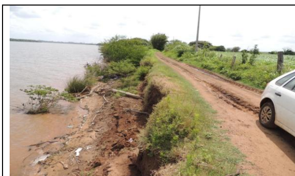
Foto 42: Detalhe da erosão da margem
