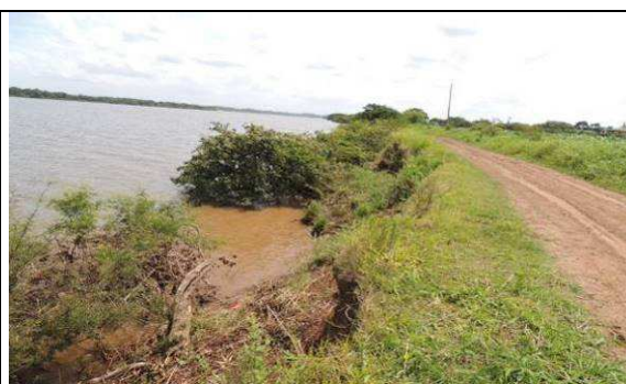
Foto 20: Detalhe da vegetação pioneira na barranca e da incidência de processos erosivos.
