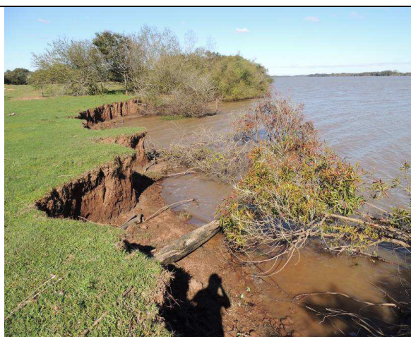
Foto 32: Detalhe da vegetação pioneira na barranca e da incidência de processos erosivos.
