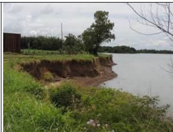
Foto 40: Detalhe do desbarrancamento que está ameaçando a via vicinal paralela à margem, próximo do ponto amostral E10A.
