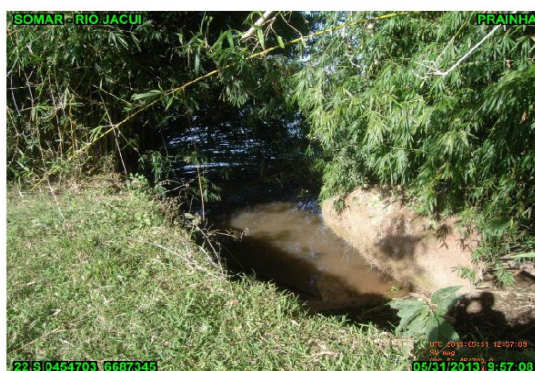
Erosão do talude na base do bambual
