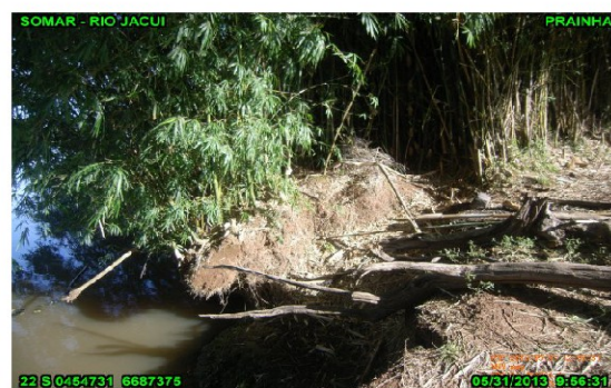
Detalhe da erosão na base do bambual
