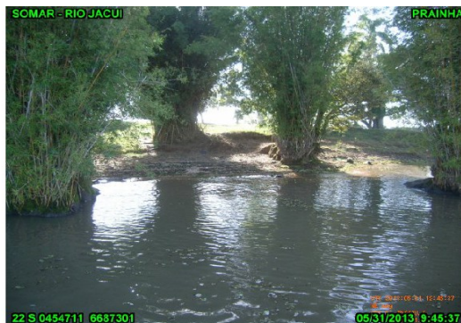
Aspecto da erosão na margem/talude
