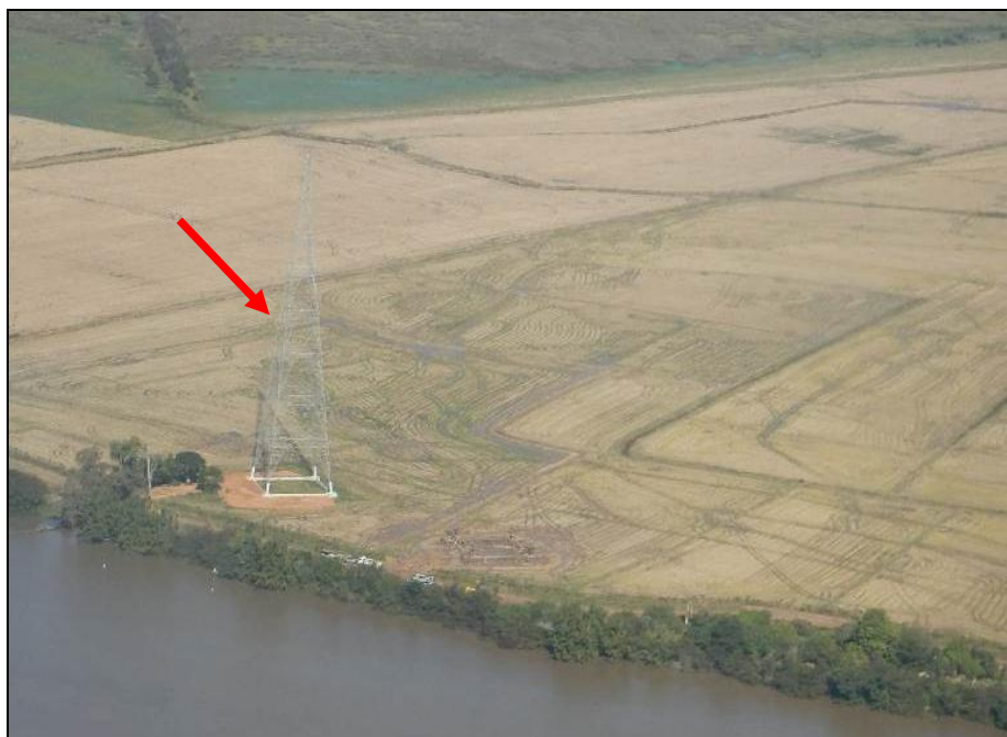
Imagem 10 – Torre de alta tensão instalada na margem direita do rio Jacuí, na Fazenda São José em Charqueadas. Observa-se a proximidade da mesma à margem do rio.
