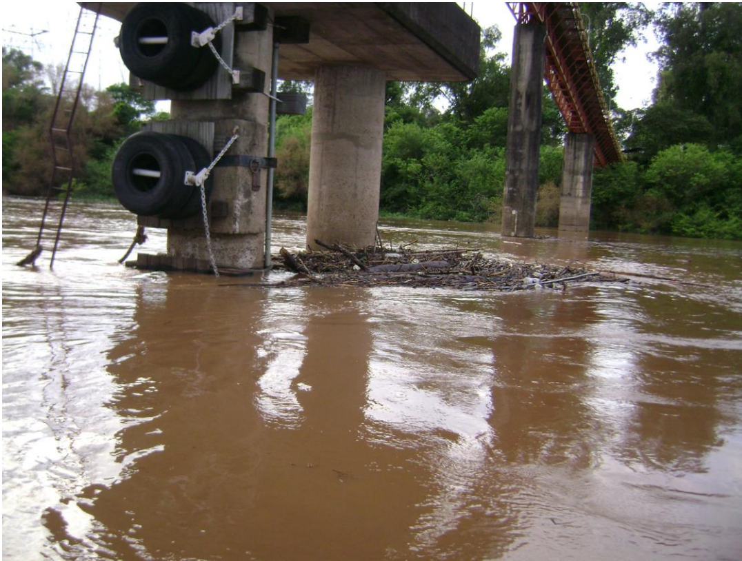
Foto 09 - Janeiro 2010 - Enchente - Régua SPH submersa
