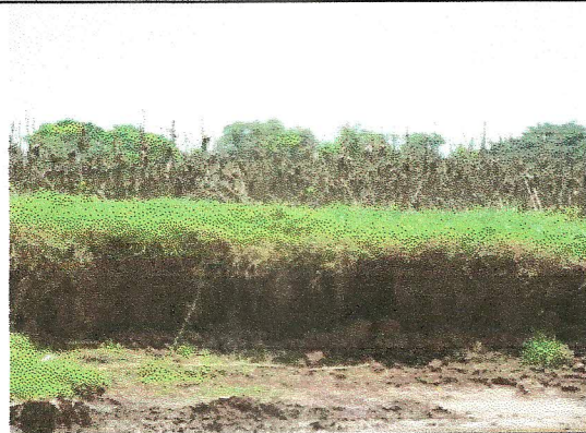
23- Detalhe para o plantio de milho na Ilha da Fanfa com evidente erosão do talude.
