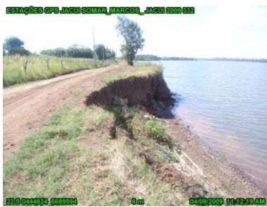
MT1 (instável = altamente erosiva)
