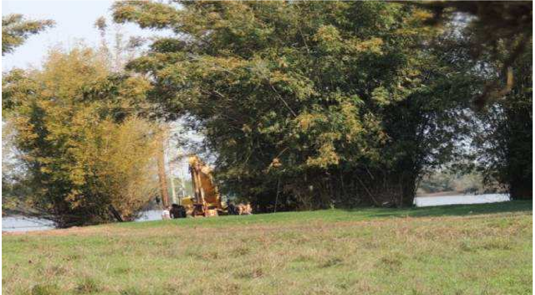
Imagem 15 – Chegada de escavadeira na ilha. Onde foram constatadas novas colisões nas taquareiras.
