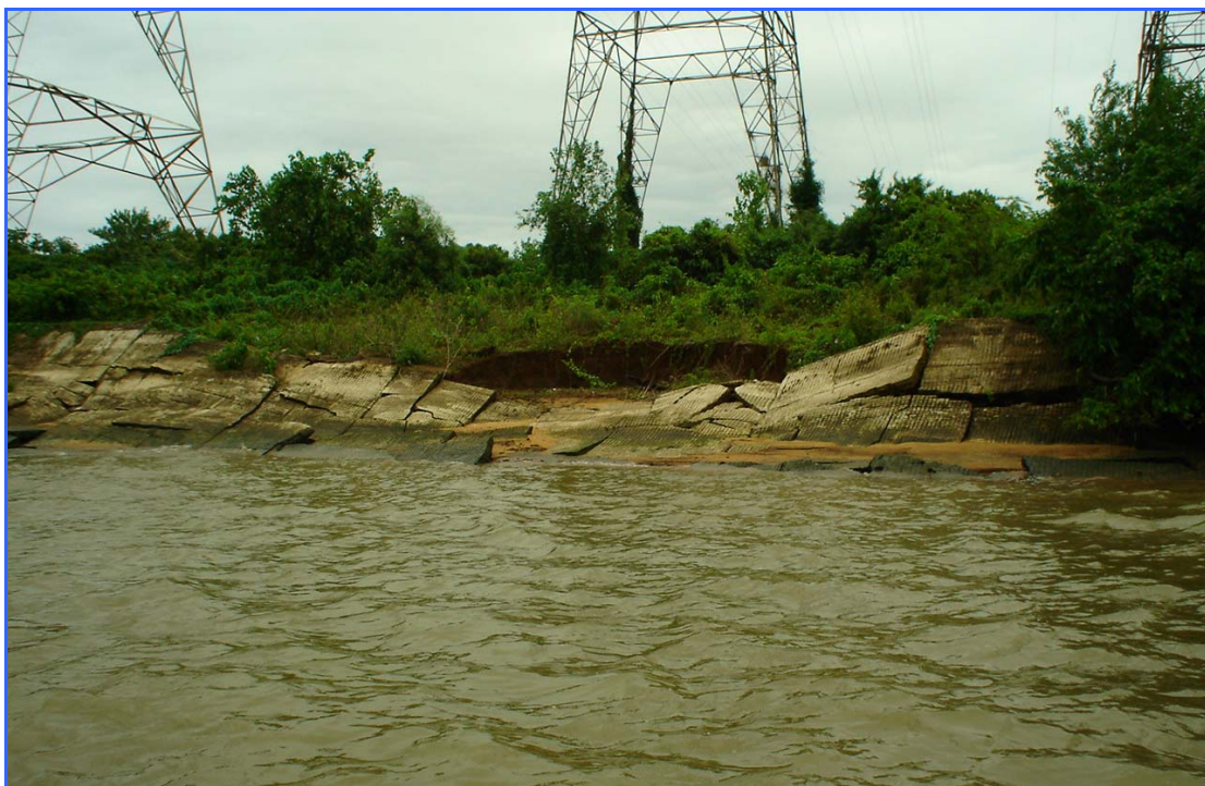
Foto 15 – Vista geral do 2º trecho de placas de argamassa completamente destruídas – neste local a posição das placas e as condições de contorno dão a indicação de que as instabilizações estão ocorrendo de cima para baixo e avanço para montante e jusante.
