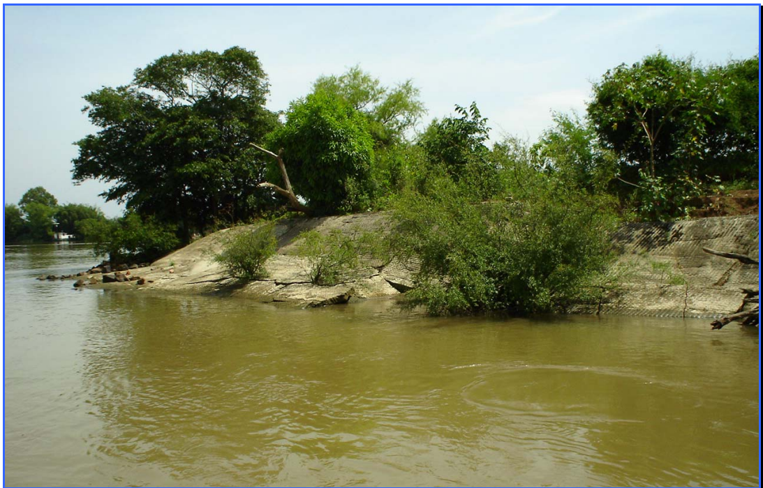
Foto 14 – Vista geral do 1º trecho de placas de argamassa completamente destruídas – neste local a vegetação ribeirinha se fixou nas fraturas das placas, o que demonstra um período prolongado de tempo sem manutenção das estruturas de estabilizadas.
