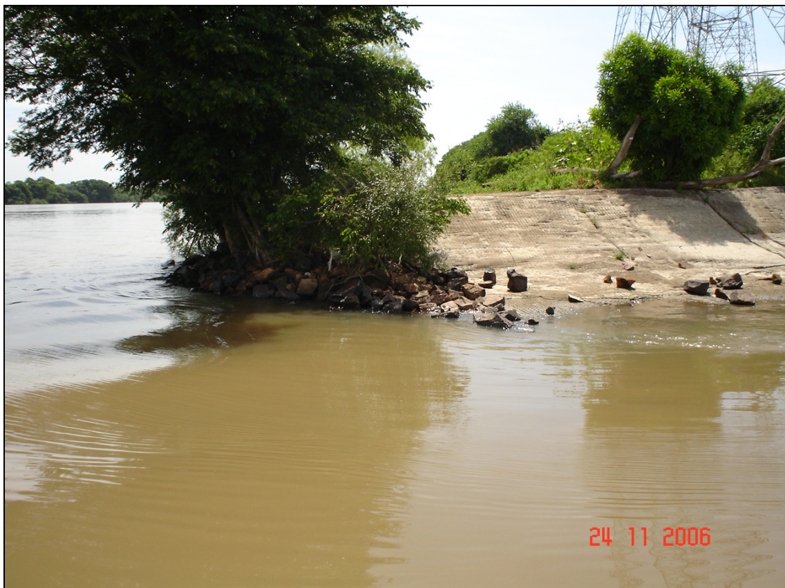
Foto 2 – Vista geral do Pontal da Ilha, mostrando as primeiras placas de argamassa de estabilização e proteção da margem direita da Ilha das Cabras – Notar o aterro de enrocamento para a proteção das primeiras placas.
