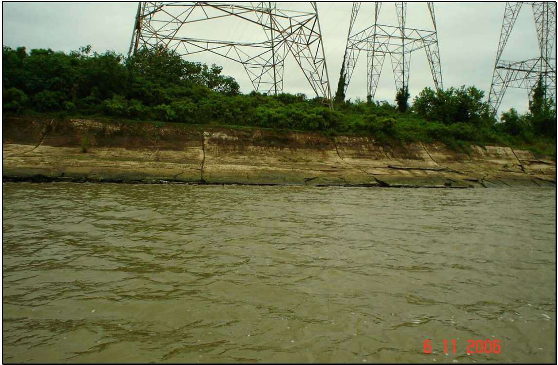
Foto 6 – Vista geral das placas de estabilização e proteção da margem direita do Pontal da Ilha, adjacentes as torres de alta tensão – ao fundo, observa-se as juntas das placas, trincas e rupturas nas suas bases.
