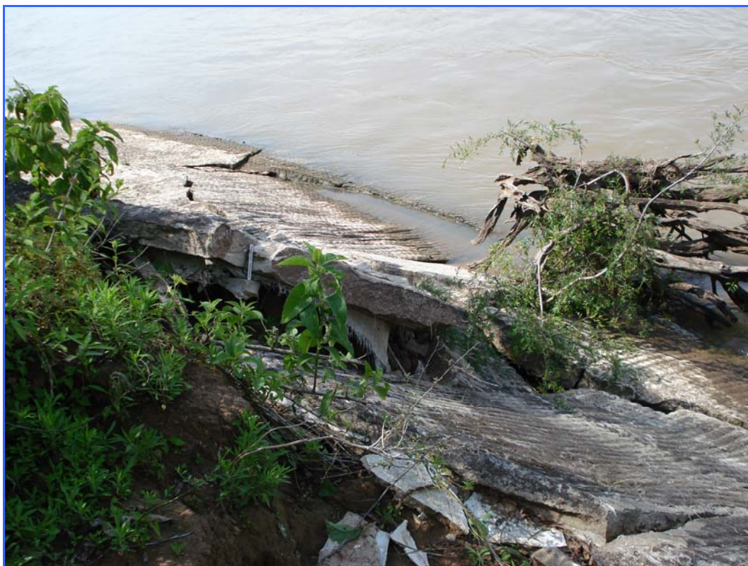
Foto 31 – Detalhes do 1º trecho de placas instabilizadas. O emaranhado de placas quebradas gera turbilhonamentos das águas e maior capacidade de arraste dos solos da fundação das placas extremas ainda estáveis.
