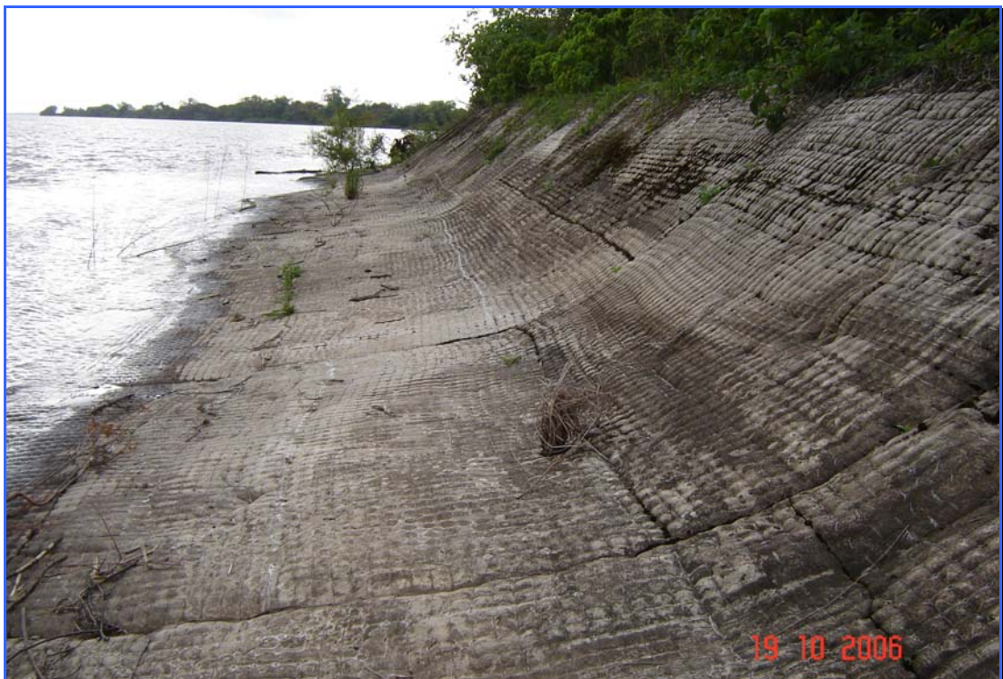
Foto 13 – Vista geral de um trecho de placas de argamassa que mostra a sua geométrica em forma de “S” – ao fundo e na curva as placas estão com sua base se instabilizando, principalmente, por consequência da progressão das erosões fluviais a partir do primeiro trecho instabilizado (ver Foto 13 e Croquis 1 e 2).
