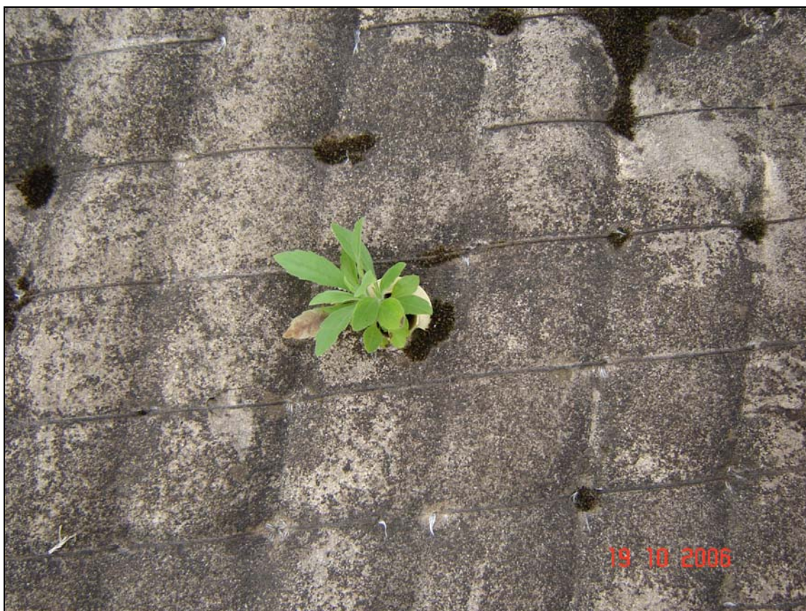
Foto 10 – Detalhes de um dreno das placas de argamassa entupido e os fios remanescentes das geoformas – a forma quadriculada e côncava comprovam que a argamassa foi injetada com pressão
