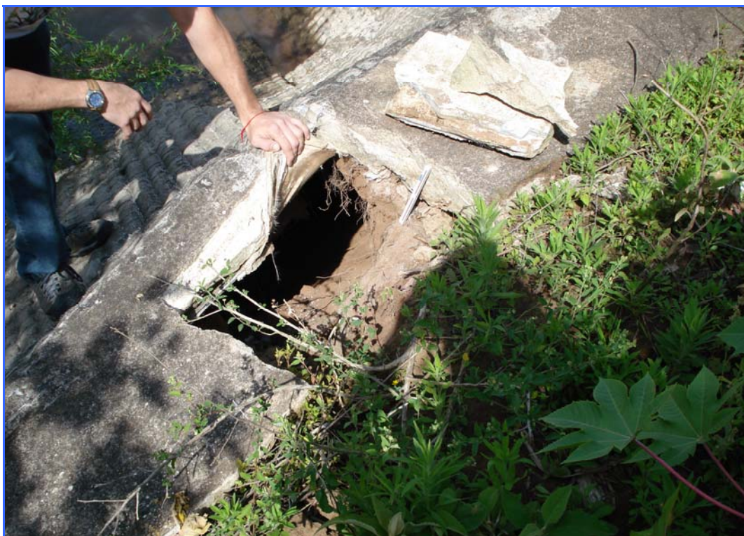
Foto 29 – Detalhes de um local com ocorrência de erosão interna no topo de uma placa de argamassa – neste local para a inspeção do tubo erosivo foi removido um pedaço da aba de argamassa, que foi colocada no lado direito da escala de referência.
