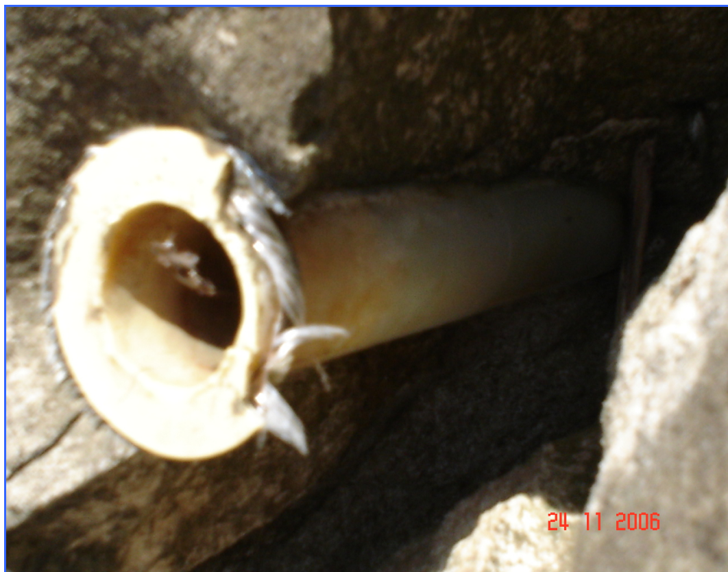
Foto 11 – Detalhes de um dreno de PVC das placas de argamassa e os fios remanescentes das geoformas
