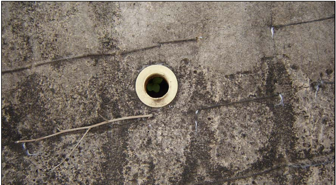
Foto 7 – Detalhes de um dos drenos das placas de argamassa – este e praticamente todos estão entupidos com solo argiloso.
