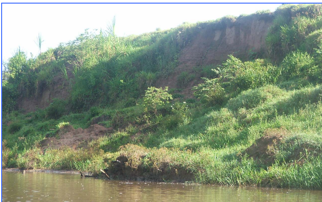
Foto 24 – Aspectos gerais e ilustrativos de uma margem de rio com escorregamentos pelo aprofundamento da sua calha, aumento da inclinação dos taludes, desmatamento, condições físicas dos solos das margens e rebaixamento rápido dos níveis do rio – foto da margem do rio Juruá no Acre.
