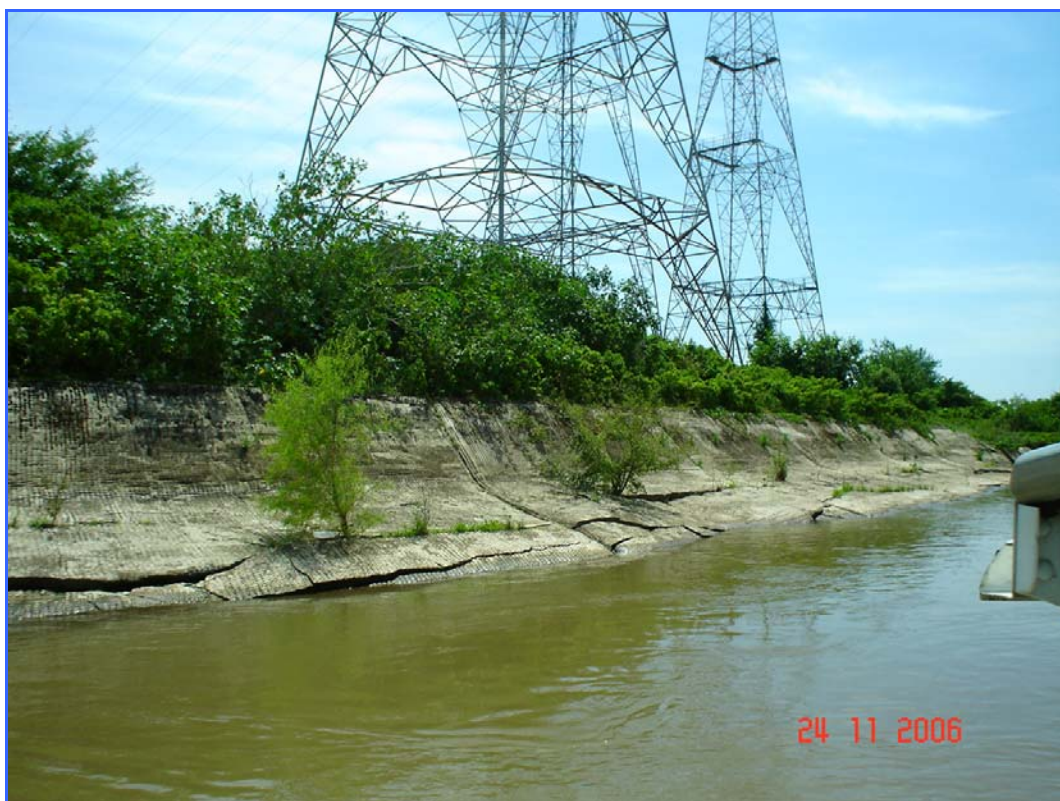
Foto 32 – Detalhes de um trecho de placas de argamassa junto e à jusante do 1º trecho estabilizado. A estabilização neste trecho está se processando pela base das placas.
