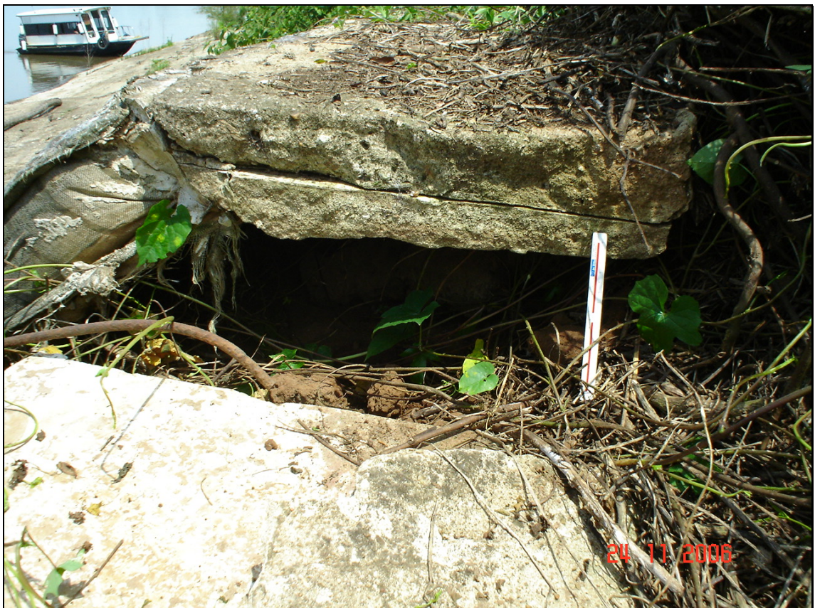
Foto 5 – Detalhes da “aba” das placas de argamassa – nesta posição, com um trecho de placa destruído, a estabilização está se dando por erosão por baixo da mesma
