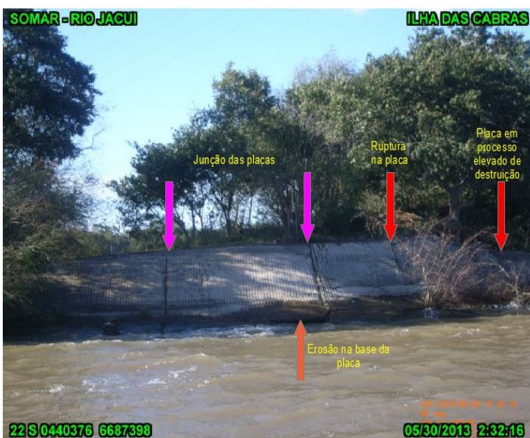
FOTO 4 Detalhe da parede de proteção e problemas observados
