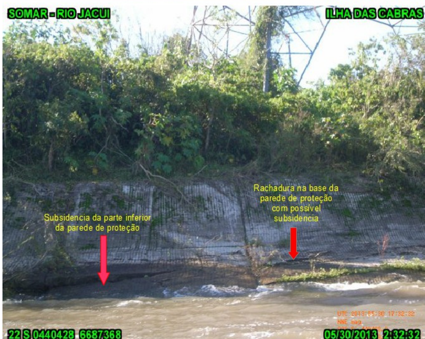
FOTO 6 Aspecto da destruição da parede pela rachadura da base e consequente subsidência.
