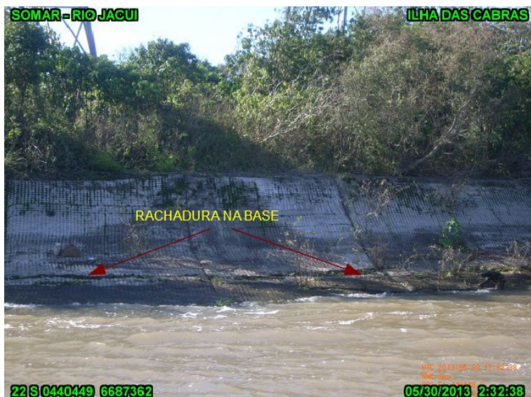
FOTO 9. Aspecto da parede mais para jusante. Nota-se a rachadura na base.
