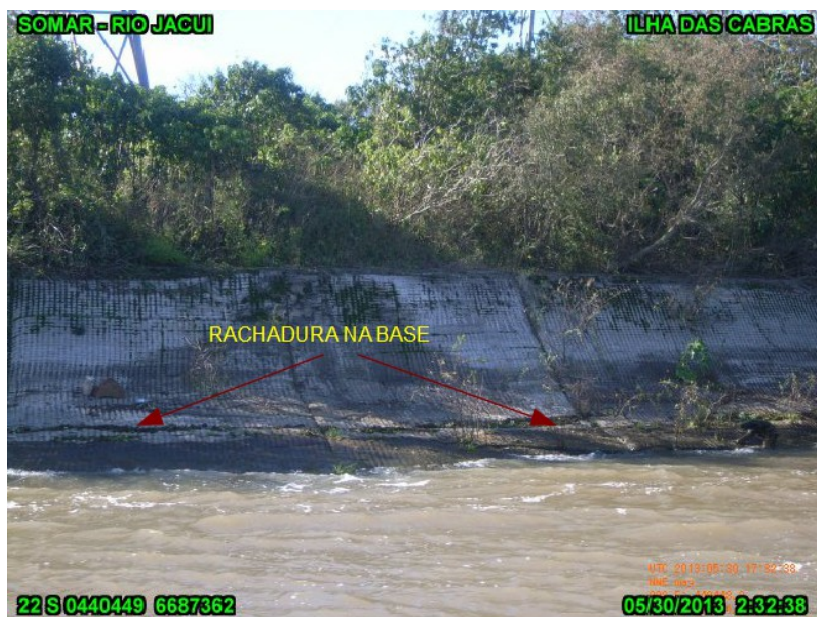
FOTO 7. Aspecto da parede mais para jusante. Nota-se a rachadura na base.
