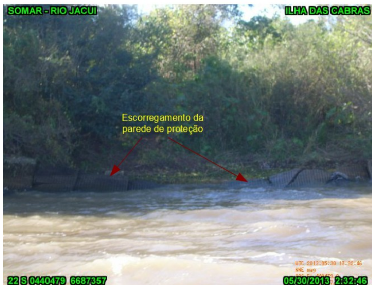
FOTO 10. Solapamento ou escorregamento da parede, provavelmente devido a erosão na base
