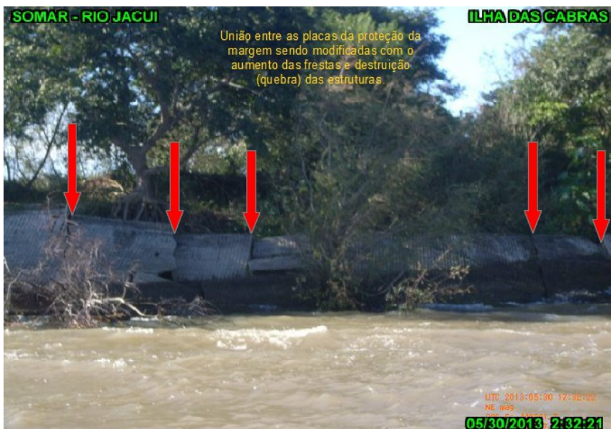
FOTO 5 União entre as placas e abertura de fissuras na parede com erosão do talude atrás da placa e deterioração da mesma
