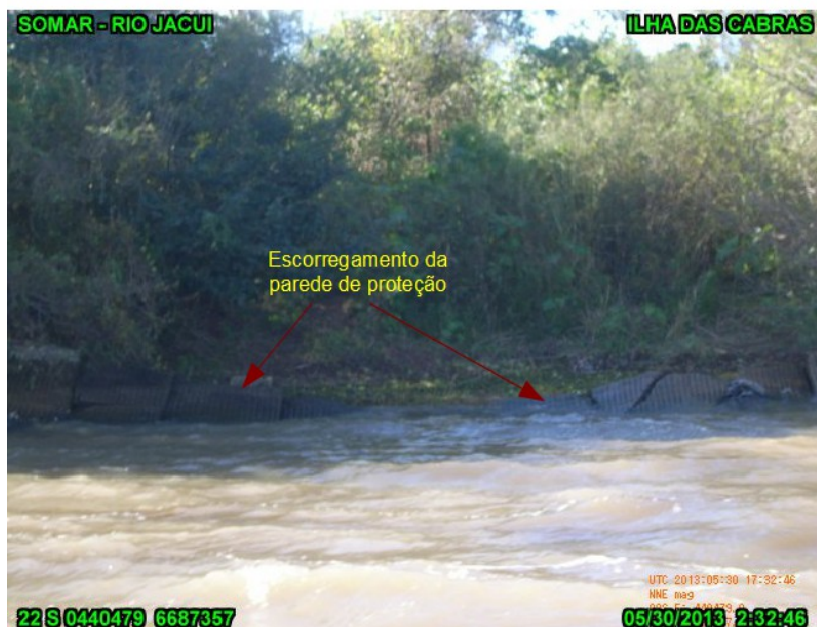
FOTO 8 Solapamento ou escorregamento da parede, provavelmente devido a erosão na base
