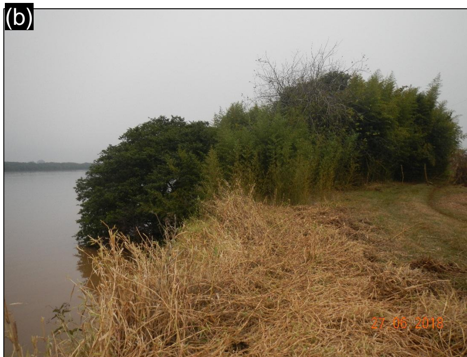
Figura 13: (ab) Detalhe do marco e vista geral do ponto de monitoramento. É possível observar o adensamento das espécies exóticas (taquaras) e que as gramíneas fixadas na face do talude estão o protegendo dos agentes erosivos.
