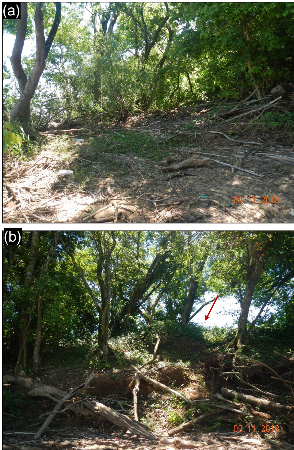
Figura 12: (a) Acumulo de galhos e materiais no pé do talude. (b) Exposição de raízes e formação de degraus no talude.
