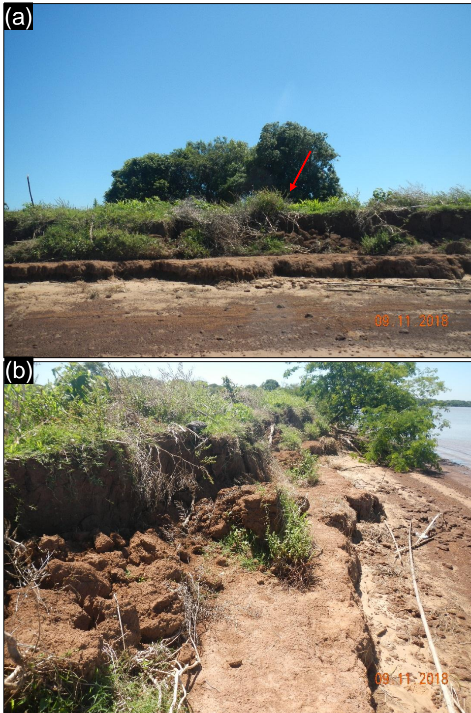
Figura 28: (a) Imagem geral do talude. Observa-se faixa de areia emersa e plantação de milho que se estende até o limite das margens desprovidas de vegetação ciliar. (b) Detalhe do perfil do talude, com a formação de degraus.
