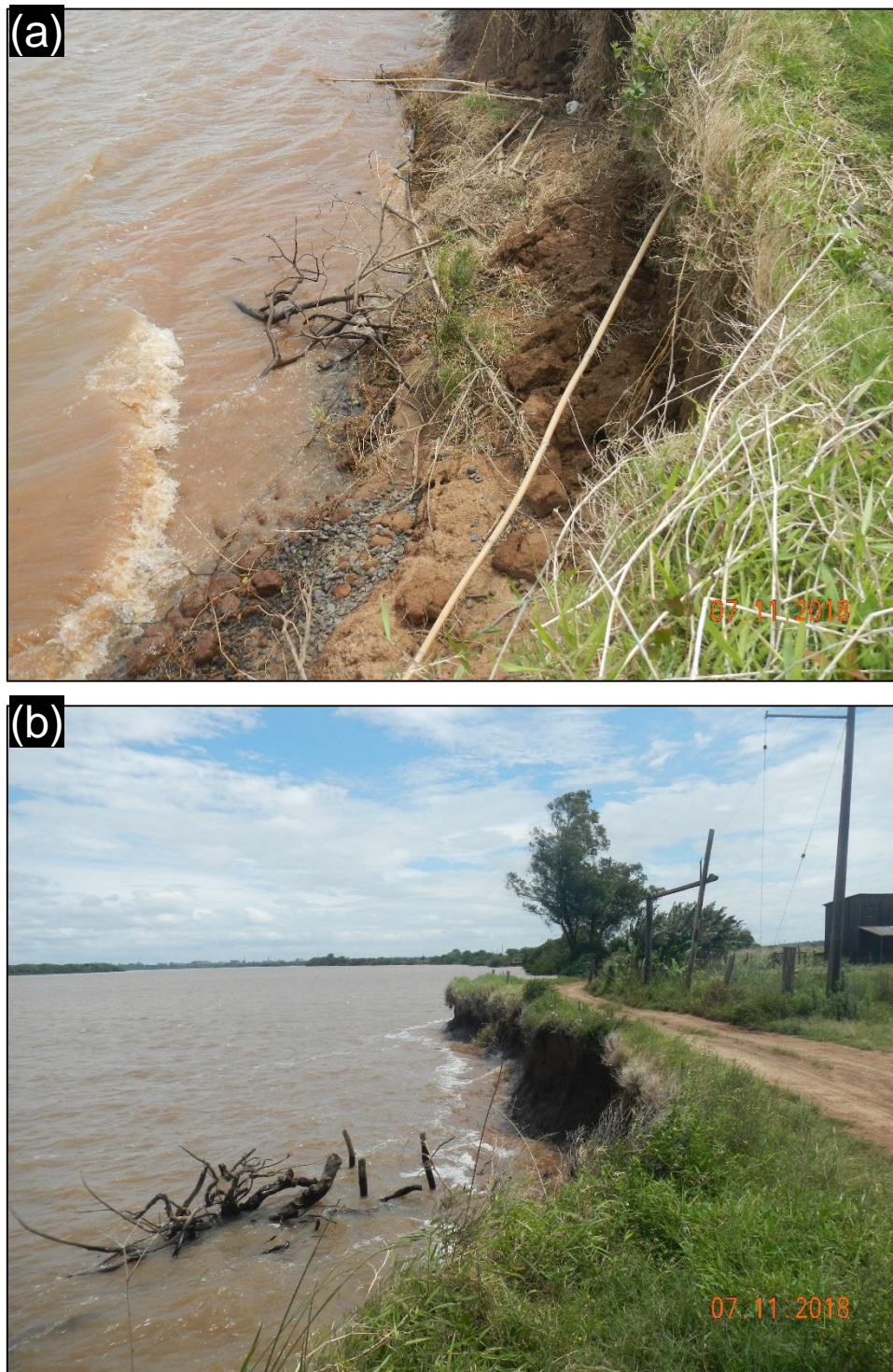
Figura 21: (ab) Imagem detalhando o entorno da área de monitoramento em novembro/2018. Observa-se a concavidade e o solapamento da margem em área próxima ao marco. A estrada vicinal que ocupa área de APP não preservada teve de ser desviada.
