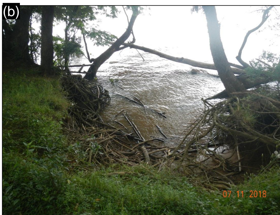
Figura 46: (a) Entorno do marco E25 em novembro/2018. Observa-se desenvolvimento de vegetação em relação ao monitoramento de junho/2018. (b) Raízes expostas e acúmulo de galhos no talude monitorado.
