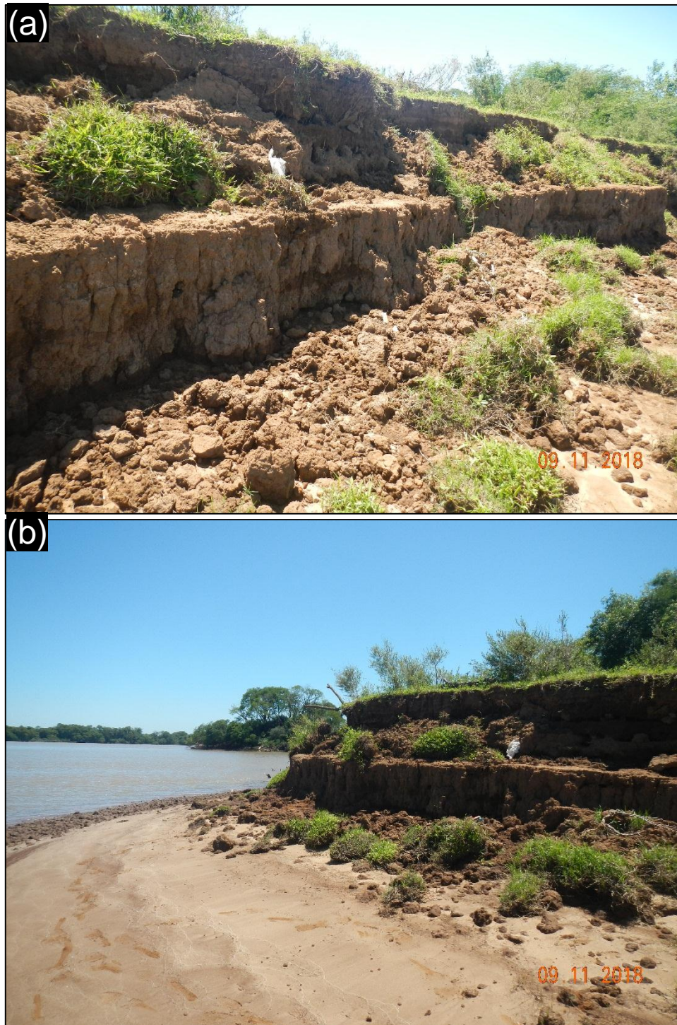
Figura 26: (a) Formação de degraus e deposição do material erodido no pé do talude. (b) Faixa de areia emersa em virtude do baixo nível do rio.
