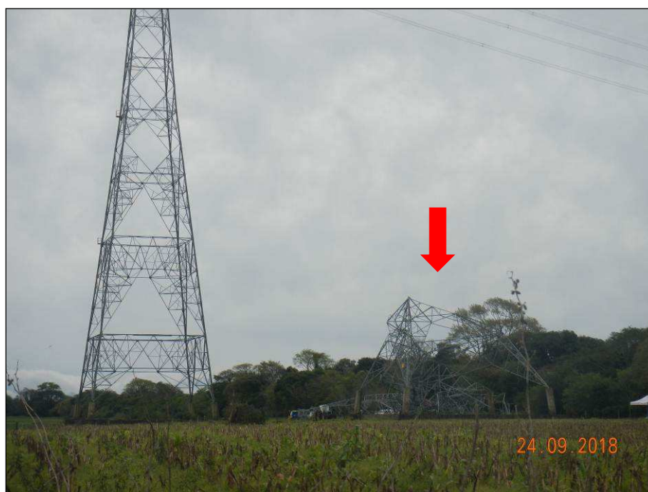
Foto 15 – Torre caída na ilha do Araújo
