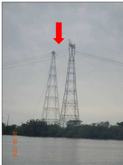
Foto 14 – Torre danificada na margem de Charqueadas.
