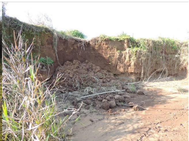
Figura 85: Flagrante de desmoronamento do talude, na primavera de 2019.
