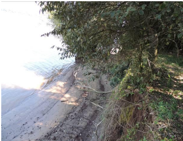
Figura 27: Detalhe da margem, a montante ao ponto amostral Veg 04, observando-se a inclinação abrupta do talude, no outono de 2019.
