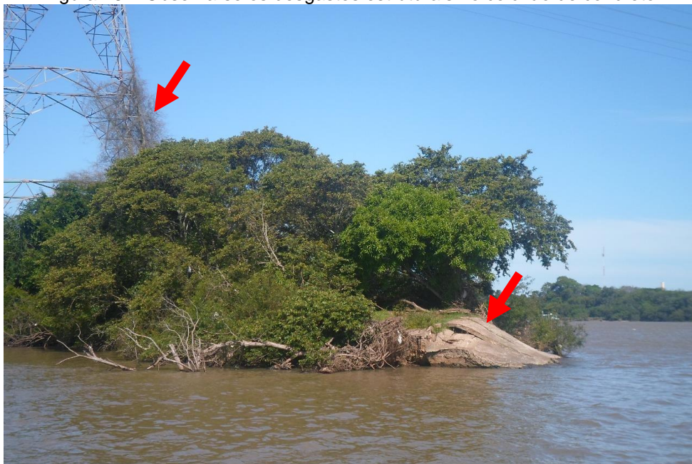
Figura 26 – Observa-se os desgastes estruturais no colchão de concreto.
