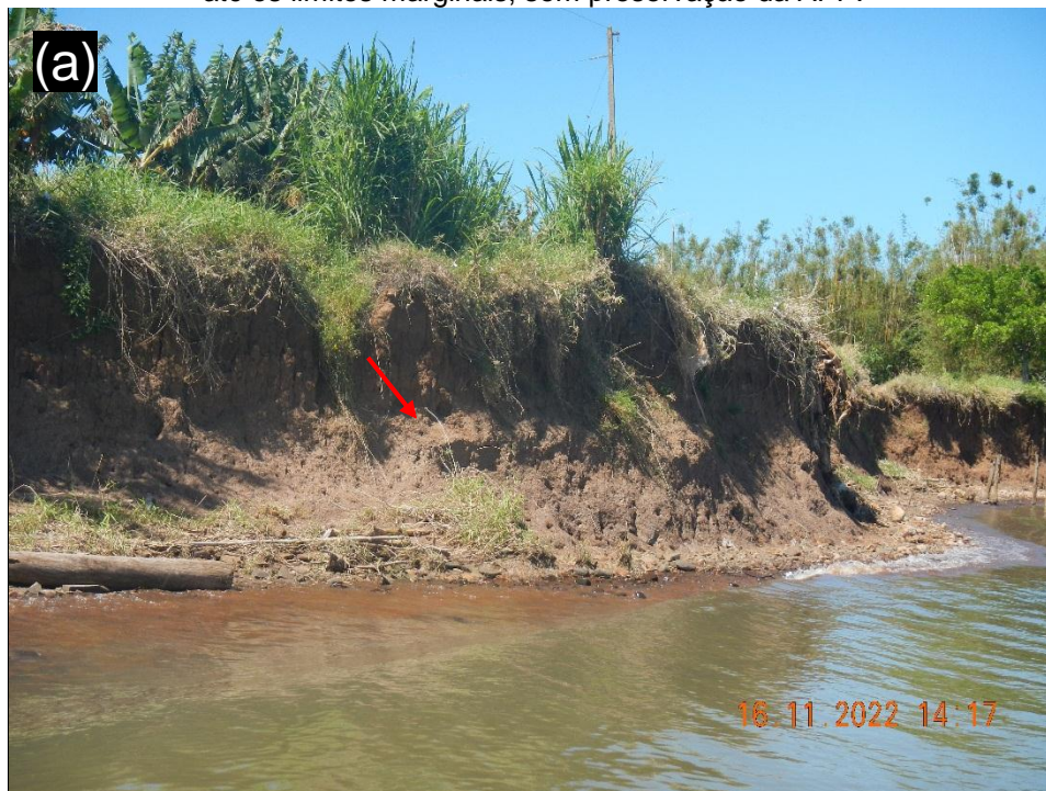
Figura 25 – (a) Imagem detalhando o talude com solo exposto, sem vegetação ciliar, sucessível a erosão, principalmente pela intensa corrente do rio. (b) Na campanha de novembro, a casa que havia no local foi desmontada, restava alguns resíduos no entorno. Possível visualizar a estrada municipal, até os limites marginais, sem preservação da APP.
