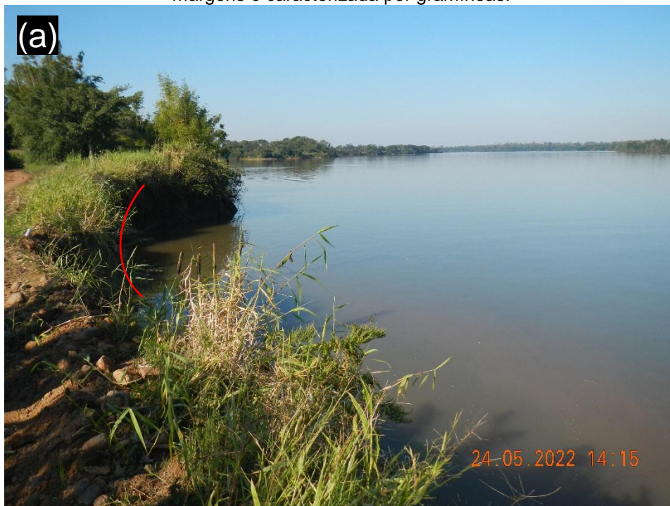
Figura 26 – (a) Foto no sentido oeste do marco ilustrando o talude marginal, possível visualizar a característica da erosão em margem côncava sem vegetação ciliar significativa. (b) Vista do marco E10B, percebe-se que quase não há talude marginal segurando o mesmo e a vegetação ciliar nas margens é caracterizada por gramíneas.
