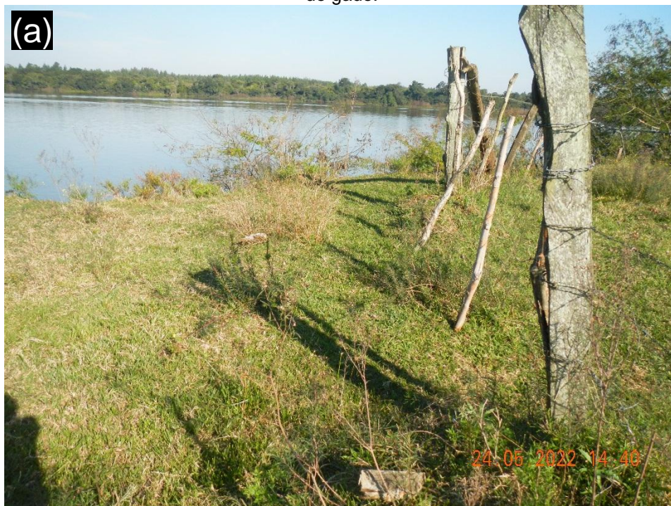
Figura 22 – (a) Vista do Marco E09 para o rio, talude sem vegetação ciliar. (b) Imagem no sentido leste do marco vistoriado, possível visualizar o talude exposto, com camadas devido ao pisoteamento do gado.
