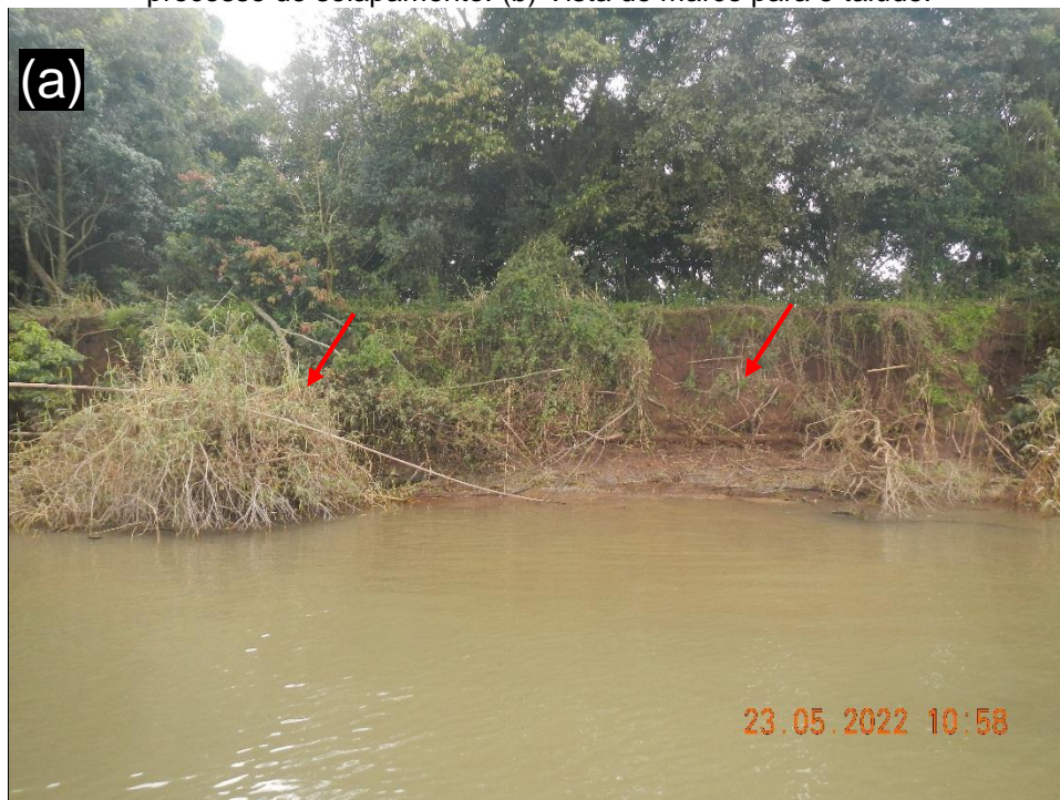
Figura 14 – (a) Vista Figura 10 – (a) Detalhe de um talude totalmente exposto no local, sucessível ao processo de solapamento. (b) Vista do marco para o talude.
