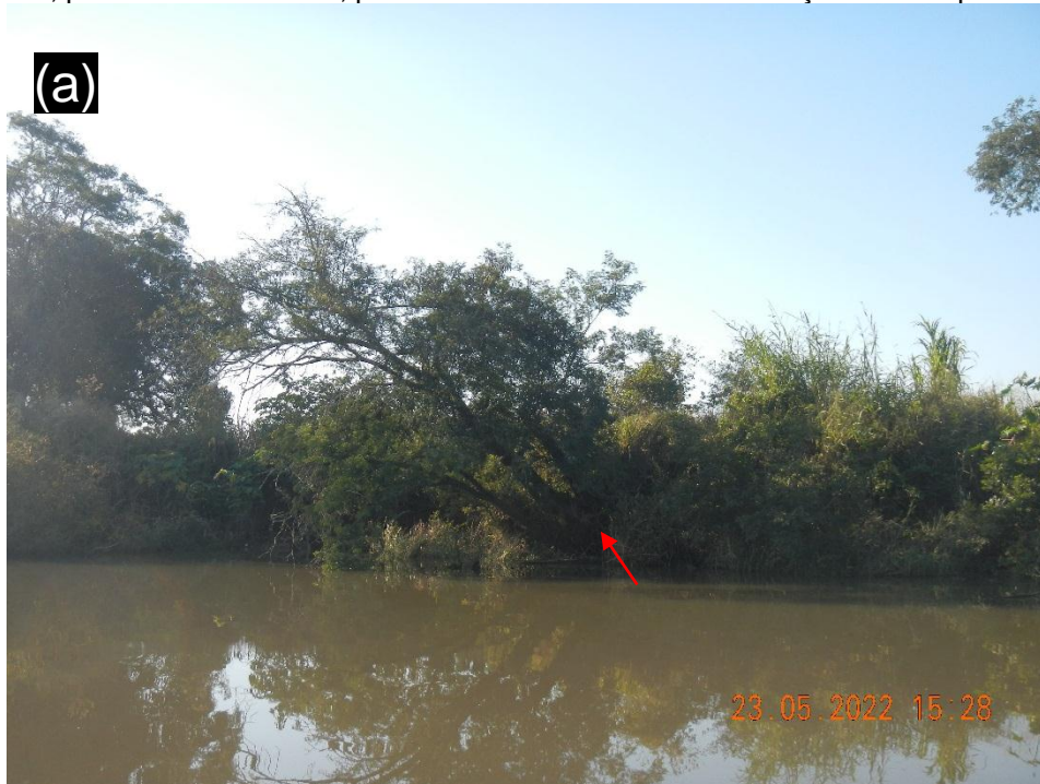
Figura 44 – (a) Detalhe da situação da margem no ponto de monitoramento. Apresenta uma vegetação densa, com alguns exemplares com risco de tombamento. (b) Vista geral da localização do Marco E19A, para o interior da ilha, possível visualizar a intensa utilização do solo para agricultura.
