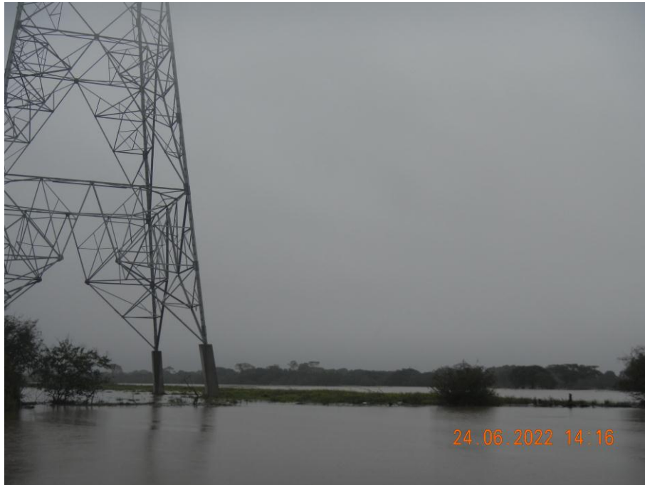
Figura 20 – Registro de 24 de junho de 2022, quando o nível do rio Jacuí sofreu elevação, sendo registrado 3,90 m no horário das 16h na régua do Cais da SOMAR. Possível visualizar que a base da torre está submersa.
