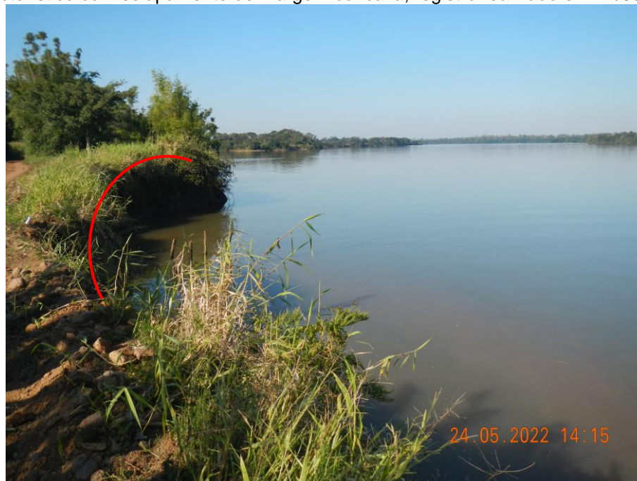
Figura 6 – No local da estrada municipal em Triunfo, possível visualizar o talude marginal característico com solapamento de margem côncava, registro realizado em 24/05/2022
