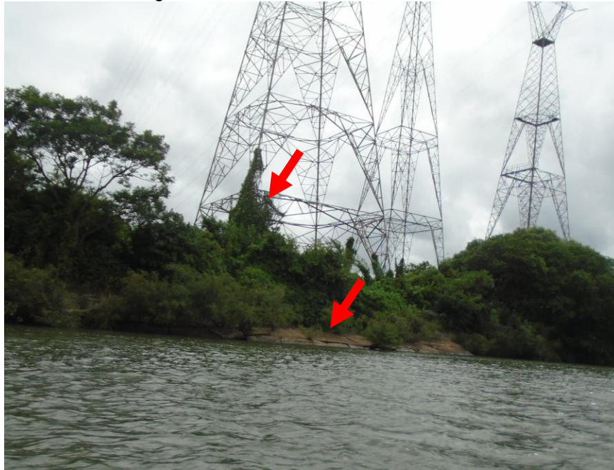
Figura 25 – Registro em 05/12/2022 pela equipe de fiscalização da SOMAR, possível observar os desgastes estruturais no colchão de concreto.
